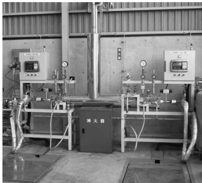
【液化ガス (LGC容器) 自動充填設備 施工例】
